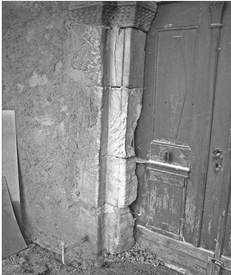
Ein rostender Dübel hat an der Kirche von Droyßig zwei Werksteine auf dem Gewissen / Bild: Bennert Monumedia
